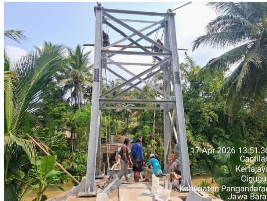
Gambar 5. 3 Pekerja tidak menggunakan APD
