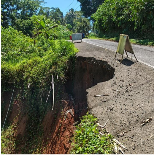
Area Yang Terdampak Longsor di Bagian Badan Jalan
