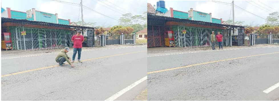
Gambar. Retak ( Cracking )
