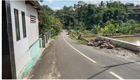
Gambar 4.13 Kondisi Jalan (Kampung Nila)
