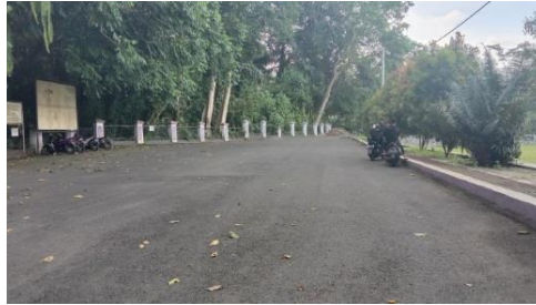
Gambar 4.9 Kondisi Jalan (Astana Gede)
