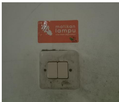
Himbauan Energi Listrik
