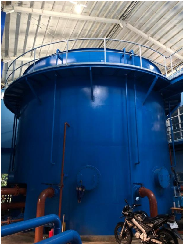
Instalasi Pengolahan Air
