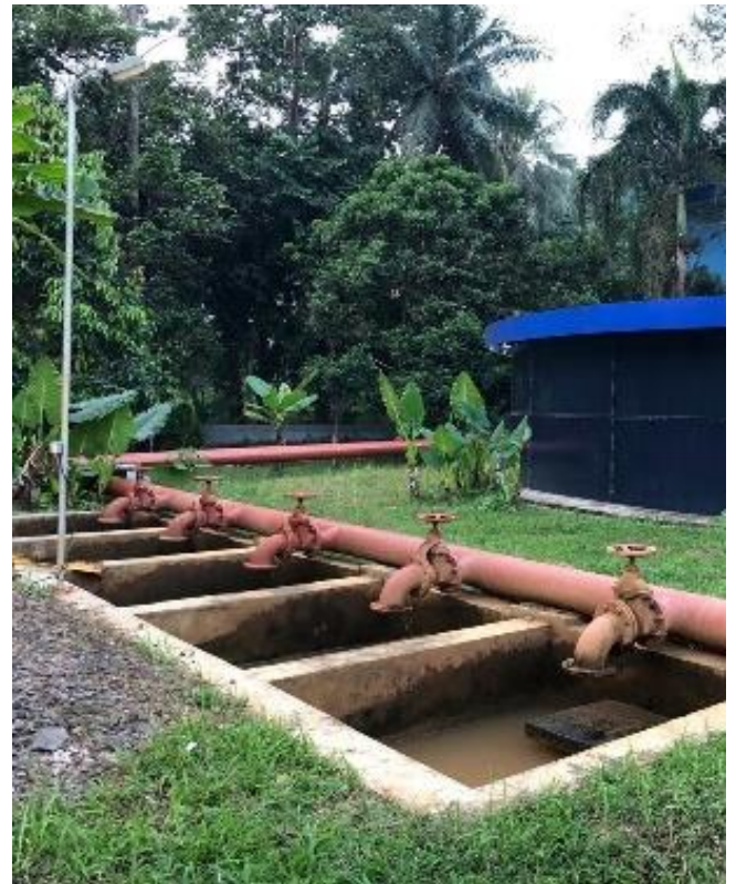
Bak Sand Drying Bed (SDB) atau Bak Pengering Lumpur
