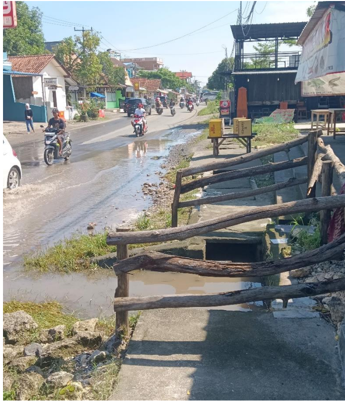
Gambar Kondisi Ruas Jalan Saat Tergenang Air
