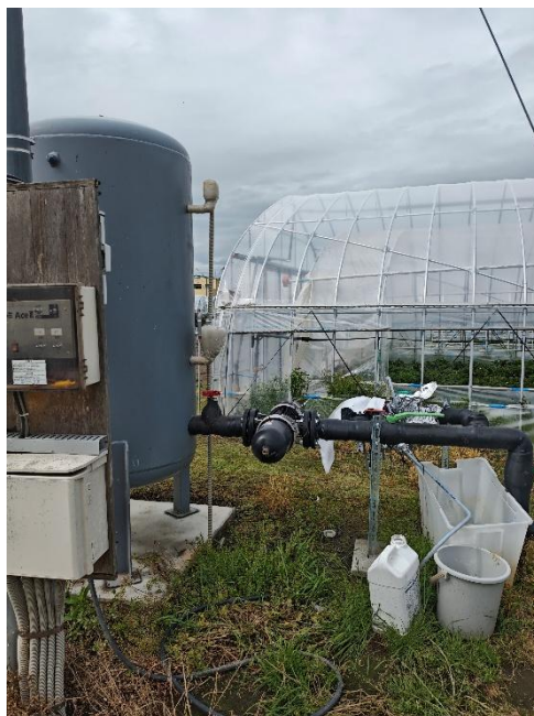
Tanki penyaringan dan pengolahan air
